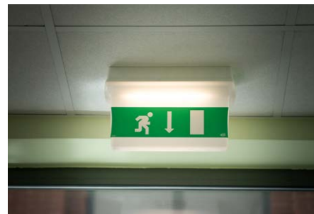
Medición de luces de emergencia y evacuación
